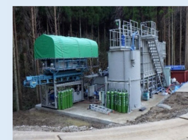
⑨濁水処理装置の設置
