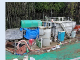
⑩濁水処理装置の設置(処理能力80t/時間)
