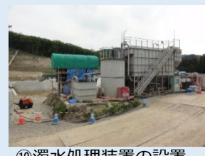
⑩濁水処理装置の設置(処理能力100t/時間①)(2022年8月に撤去)
