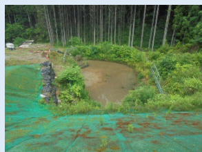
④仮設沈砂池の適切な維持管理
