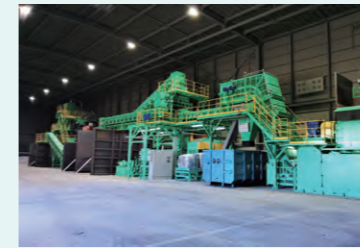
川崎リサイクルセンターの光学選別機を含む可燃物の選別・破碎設備ライン
