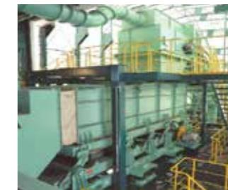
機械選別設備 (1)
