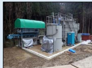
濁水処理プラント
