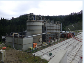
⑩濁水処理装置の設置（処理能力100t/時間②） （2023年7月に撤去）
