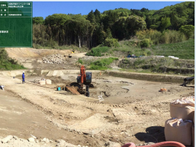
④仮設沈砂池の適切な維持管理
