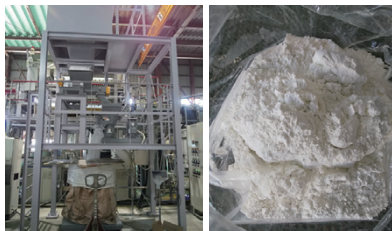
リン回収設備
